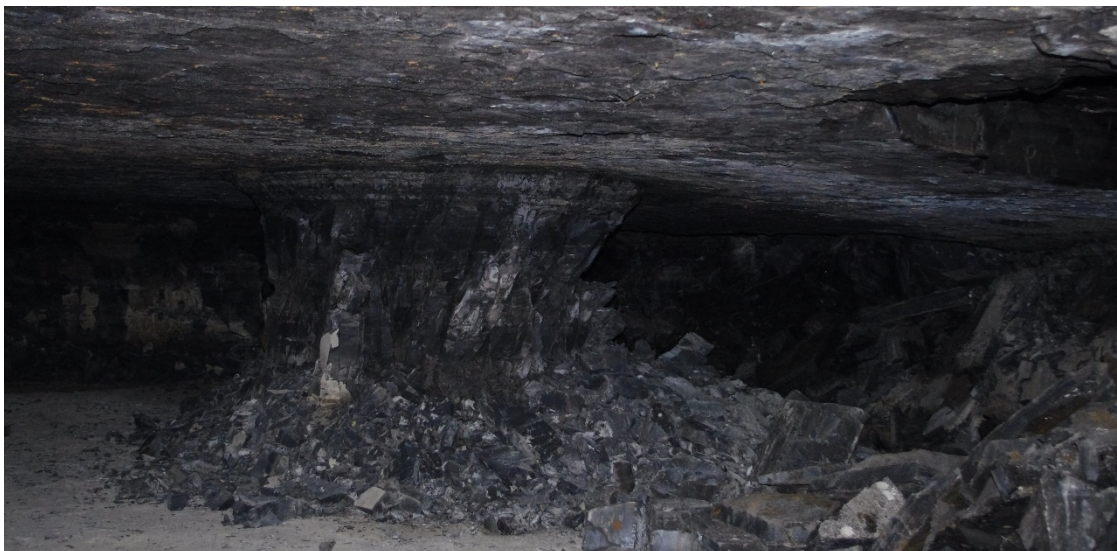
Zone effondrée (partie droite) et pilier en bordure d'effondrement
